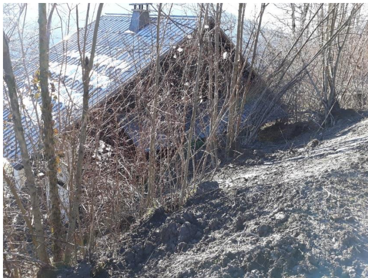
conséquences sur les habitations en aval
